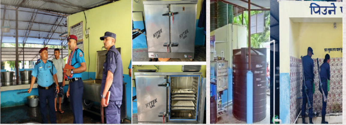
धुवौँ रहित आधुनिक प्रविधिको प्रायोग गरी खाना तथा तरकारी पकाउन विद्युतीय मेसिनका साथै शुद्ध पिउने पानी व्यवस्थापनका लागि Water treatment plant को व्यवस्था।
